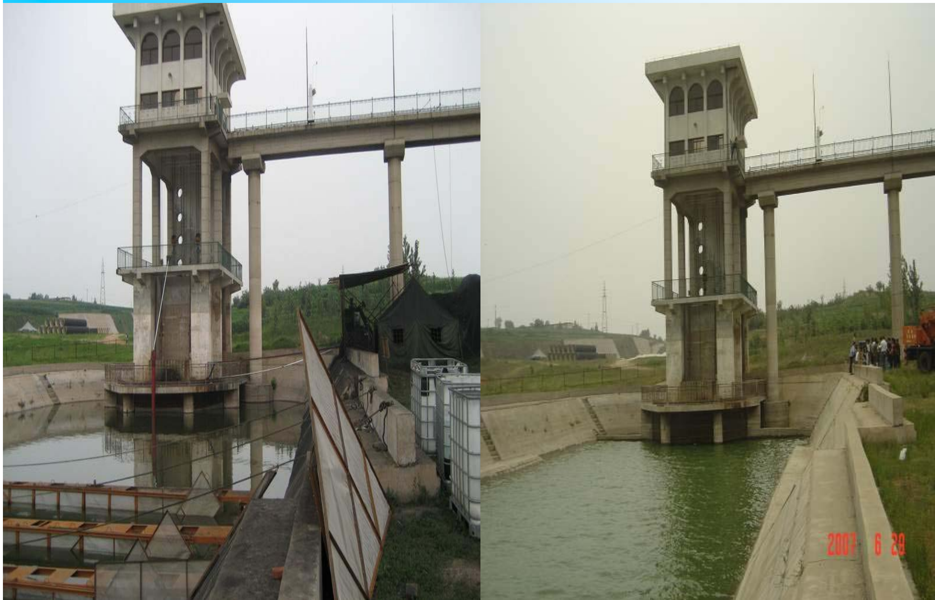
安装调试完成的水源地水质应急预警实时监测系统
